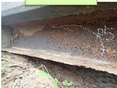
損傷区分 e
