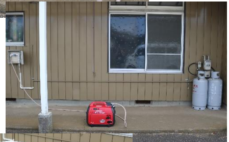
【写真右】 LPガス発電機 をつないだ様子
