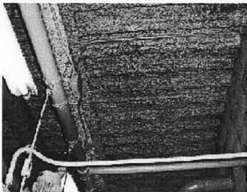
石綿含有吹付けロックウール
