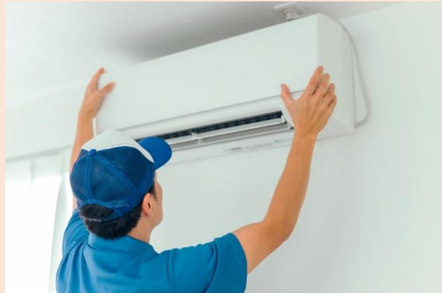
令和 4 年 7 月から、 単身高齢者宅へのエアコン整備補助金を創設！
