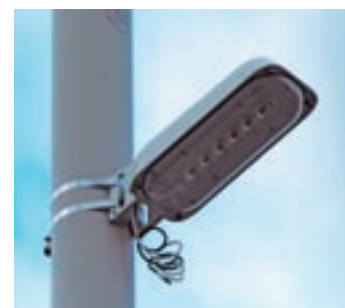
LED照明を使用した防犯灯
