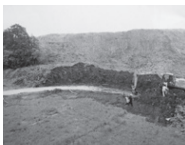
残土による町道堰止め現場
