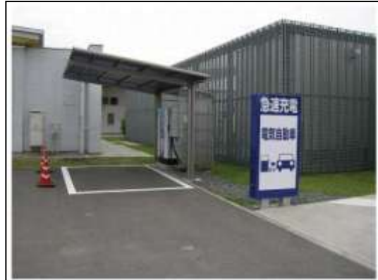
EV用急速充電施設（道の駅思川）
