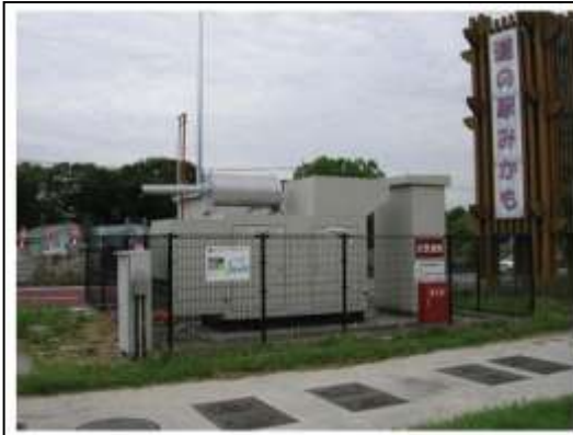
自家発電装置（道の駅みかも）
